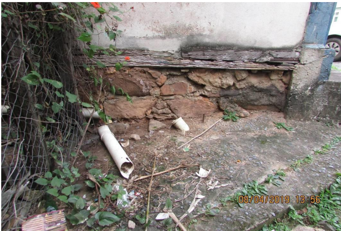
Imagem 11: Tubulação de esgoto aparente residências e presença de intervenções em concreto. Fonte: Ana Paula Viana Reis, 08/04/2019.
