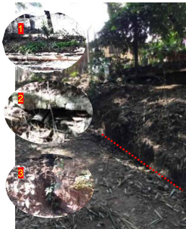
Figura 25 – Conformidade do talude deformado. Lupa 1: mureta danificada; Lupa 2: tubulação da saída do esgoto; lupa 3: esgoto. Em pontilhado de vermelho destacando o escoamento do esgoto. Fonte: Márcia Souza; 22/07/2020.
