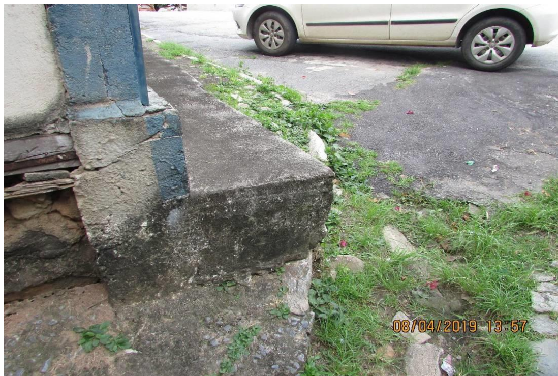
Imagem 14: Vegetação Invasiva nas calçadas em pedras pé de moleque com intervenções em concreto e asfalto. Fonte: Ana Paula Viana Reis, 08/04/2019.
