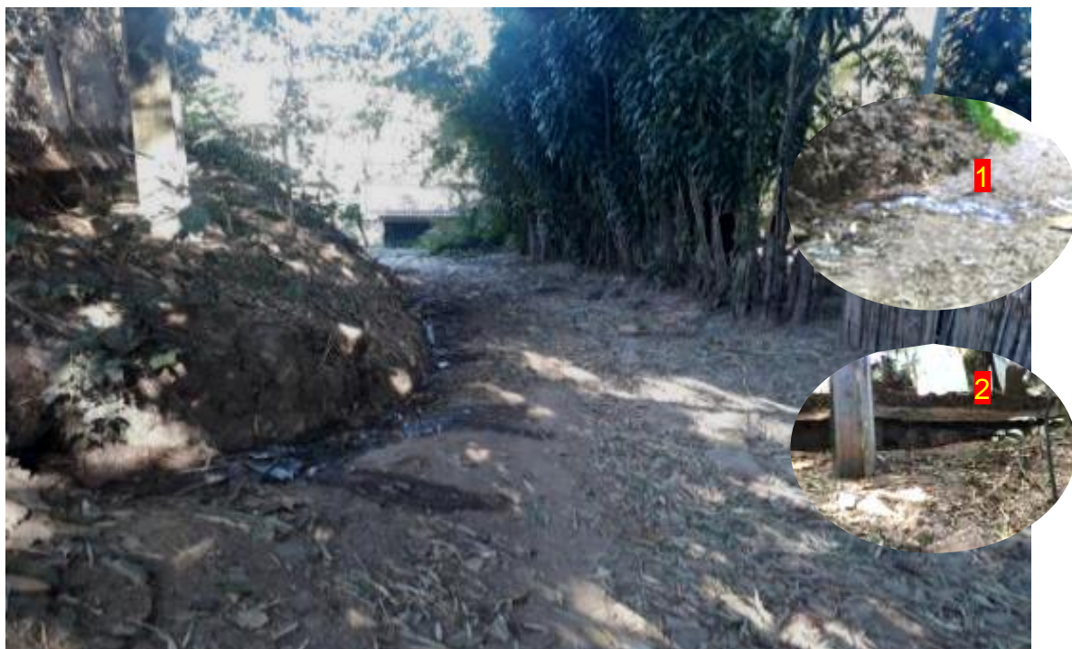
Figura 27 – Saída do Beco do Bonfim com vista para a Rua Olímpia dos Santos/Santa Luzia/MG. Conformidade do talude deformada. Lupa 1: resíduo ; lupa 2: poste em estrutura em concreto de iluminação. Fonte: Márcia Dantas; 06/07/2020.
