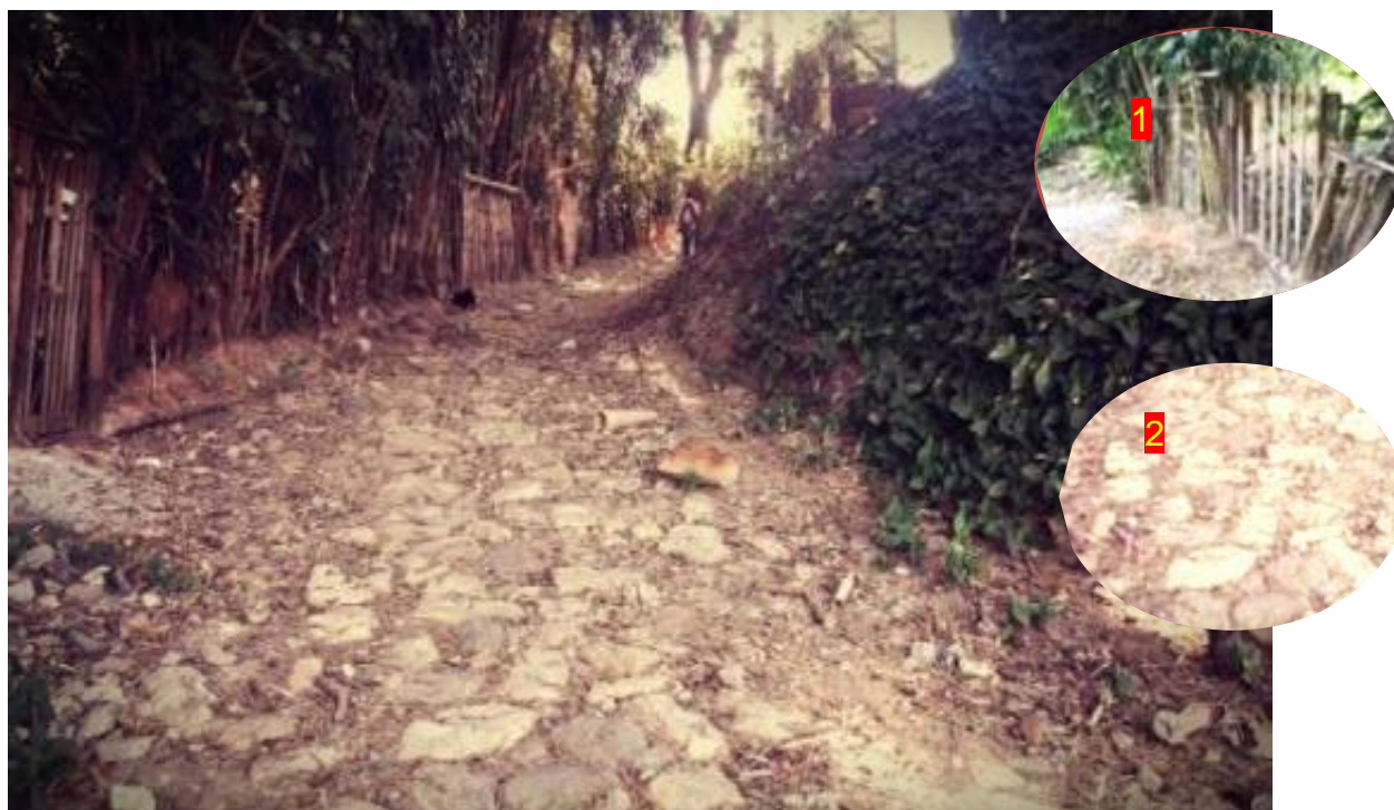
Figura 28 – Talude parcialmente coberto com a vegetação singônio Syngonium podophyllum . Lupa 1: Cercamento do vizinho com bambus ressecados; lupa 2: calçamento em pedras com ausência de algumas e sujidades. Fonte: Márcia Dantas; 06/07/2020.
