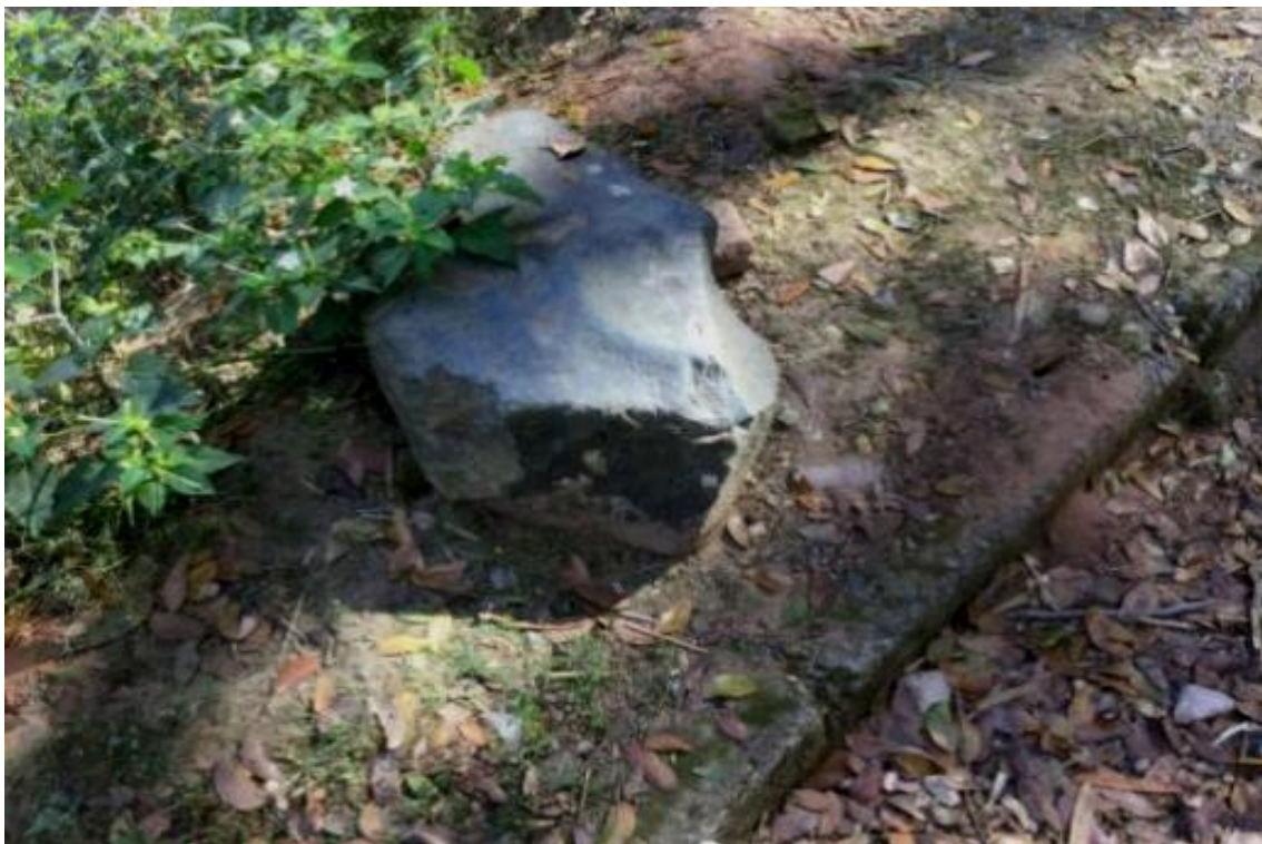
Figura 36 – Calçada voltado para a Rua Olímpia dos Santos/Santa Luzia/MG, em solo natural com acabamento em meio-fio de concreto e destaque de uma pedra grande obstruindo a passagem. Vegetação maciça ipomea ( Ipomoea cairica sp.) sobre o passeio e talude. Fonte: Márcia Dantas; 06/07/2020.
