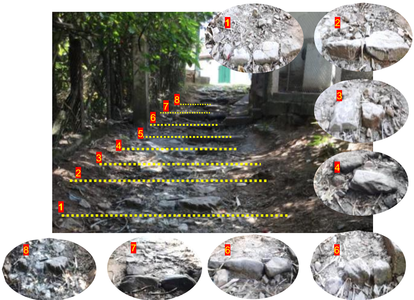
Figura 21 – Patamares da escadaria do Beco do Bonfim. Oito degraus com pedras faltantes antes das intervenções ocorridas ao longo do tempo eram em declive, existência de dois postes de iluminação desativados, cerca composta com pedaços de madeira, latão, arame farpado enferrujado e bambus na lateral direita tendo como referência a rua Silva Jardim. Fonte: Laryssa Gabrielly; 29/07/2020.
