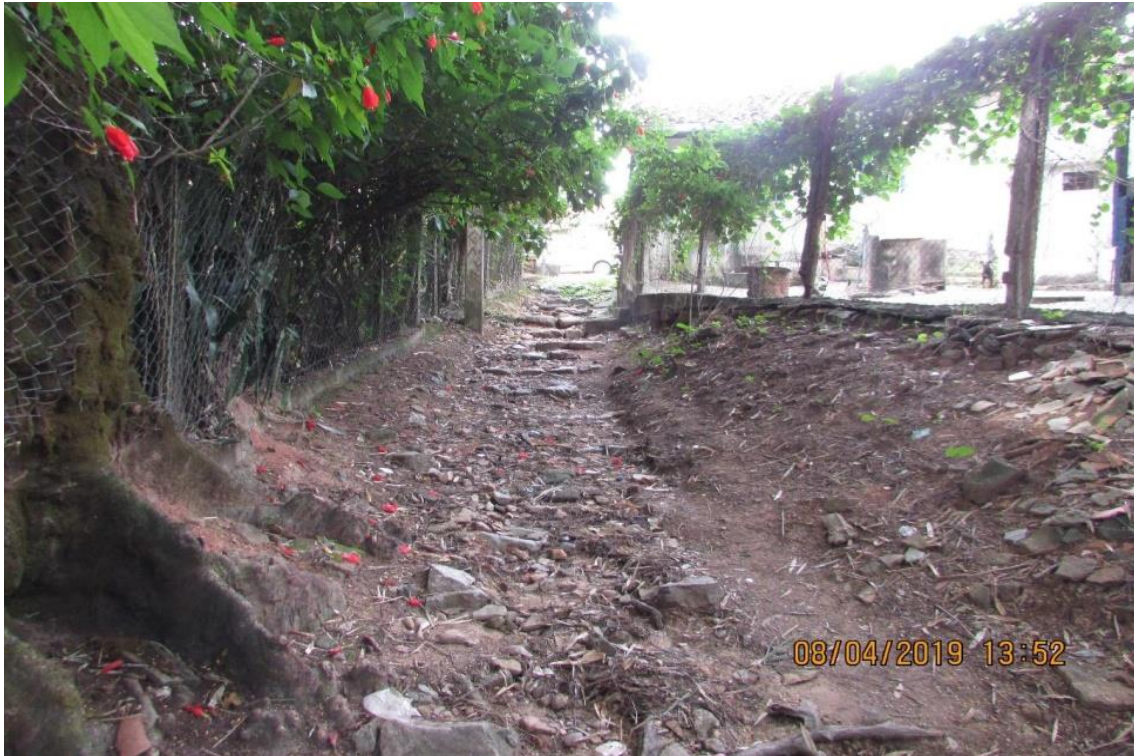
Imagem 8: Falha na composição das pedras do calçamento original, sistema radicular do pé de jatobá exposto e sujeidade. Fonte: Ana Paula Viana Reis, 08/04/2019.
