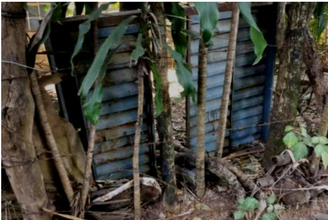
Figura 31 – Cercamento com janela enferrujada, esteios de madeiras com xilófagos, brocas de apodrecimento visíveis e três fiadas de arame oxidado. Fonte: Márcia Souza, 22/07/2020.
