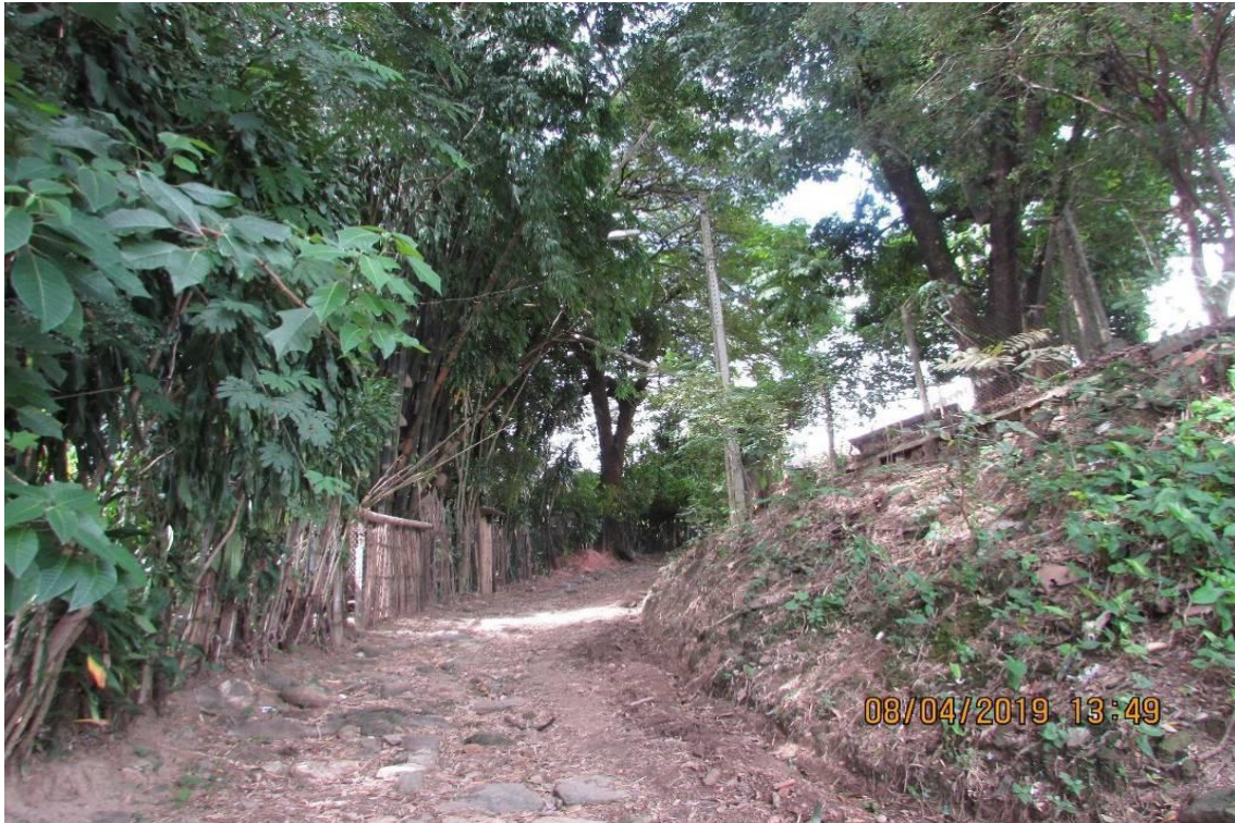
Imagem 6: Calçamento original do beco, com pedras faltantes, talude coberto com vegetações e ervas daninhas. Fonte: Ana Paula Viana Reis, 08/04/2019.
