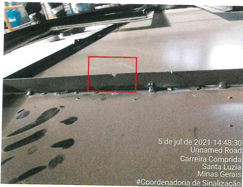
Figura 1: Destaque para o acabamento mal feito (cantoneira com falha – quinas vivas / risco de corte)
