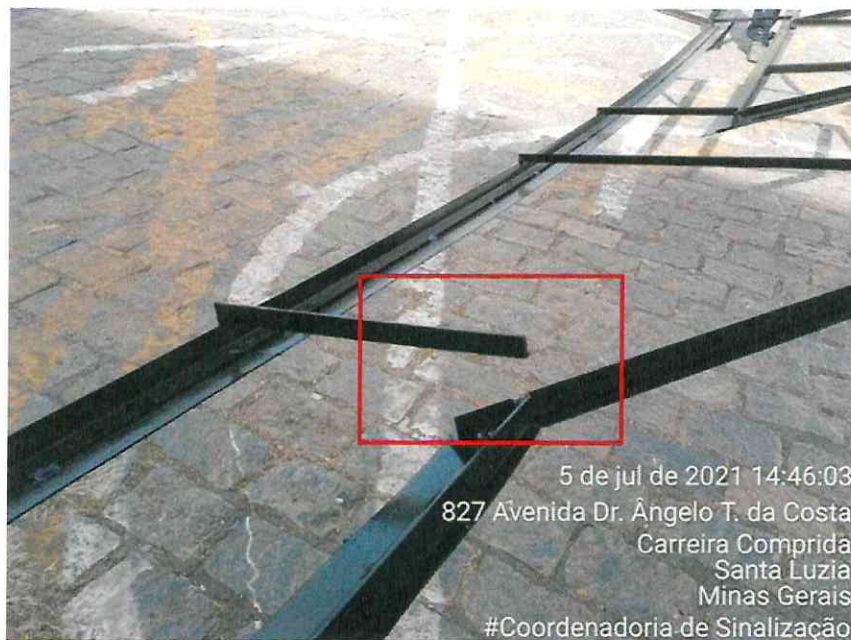
Figura 4: Destaque para a emenda quebrada
