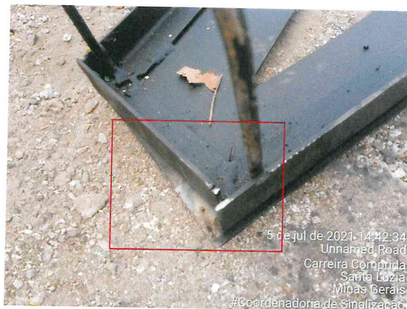
Figura 2: Destaque para o acabamento mal feito (quinas vivas – risco de corte)
