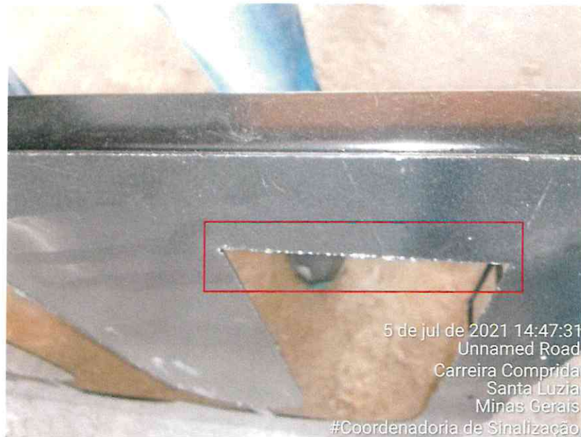
Figura 3: Destaque para o acabamento mal feito (superfície irregular)
