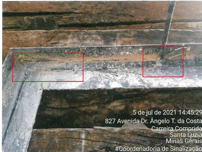
Figura 5: Destaque para os pontos de solda na parte interna, dificultando a limpeza após o uso
