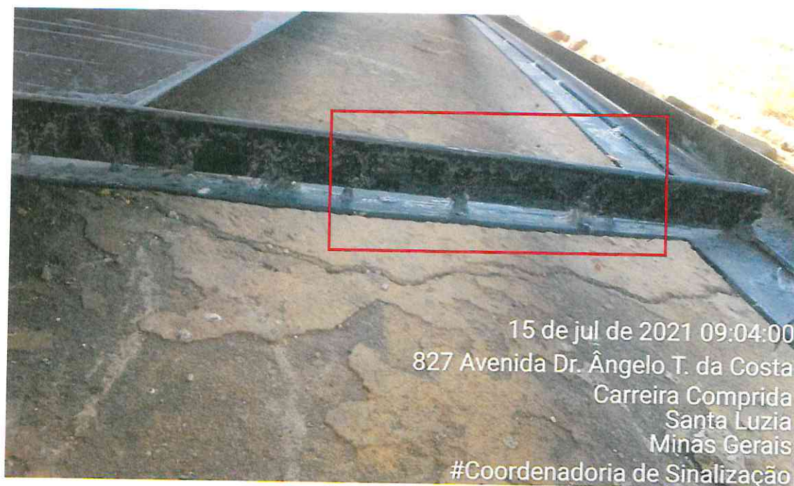
Figura 2: Destaque para o acabamento mal feito (superfície irregular) e para os pontos de solda, dificultando a limpeza após o uso.
