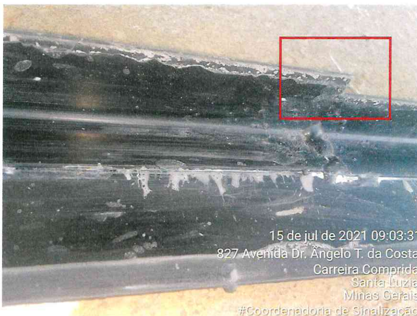
Figura 1: Destaque para o acabamento mal feito (quinas vivas / risco de corte)
