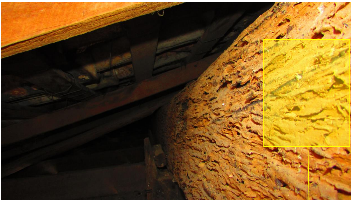
Vista do frechal com infestação de xilófagos.
