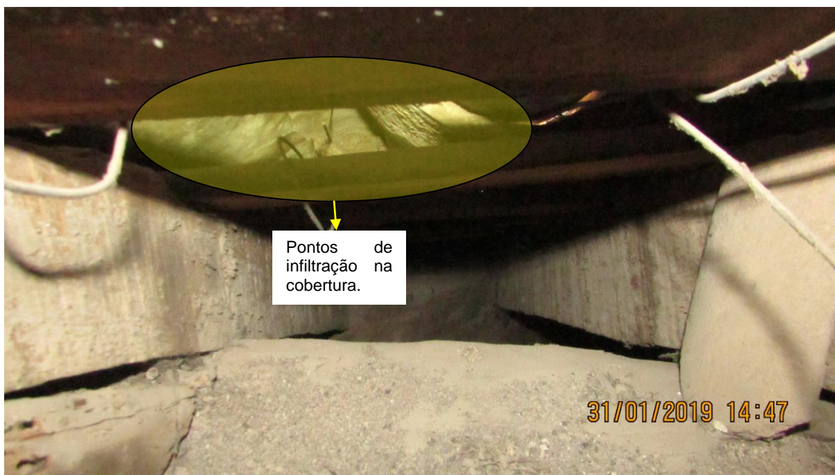
Figura 35 Vista interna da cobertura, com anomalias especificadas. Foto: Gabriel Vidal, 12/11/18.
