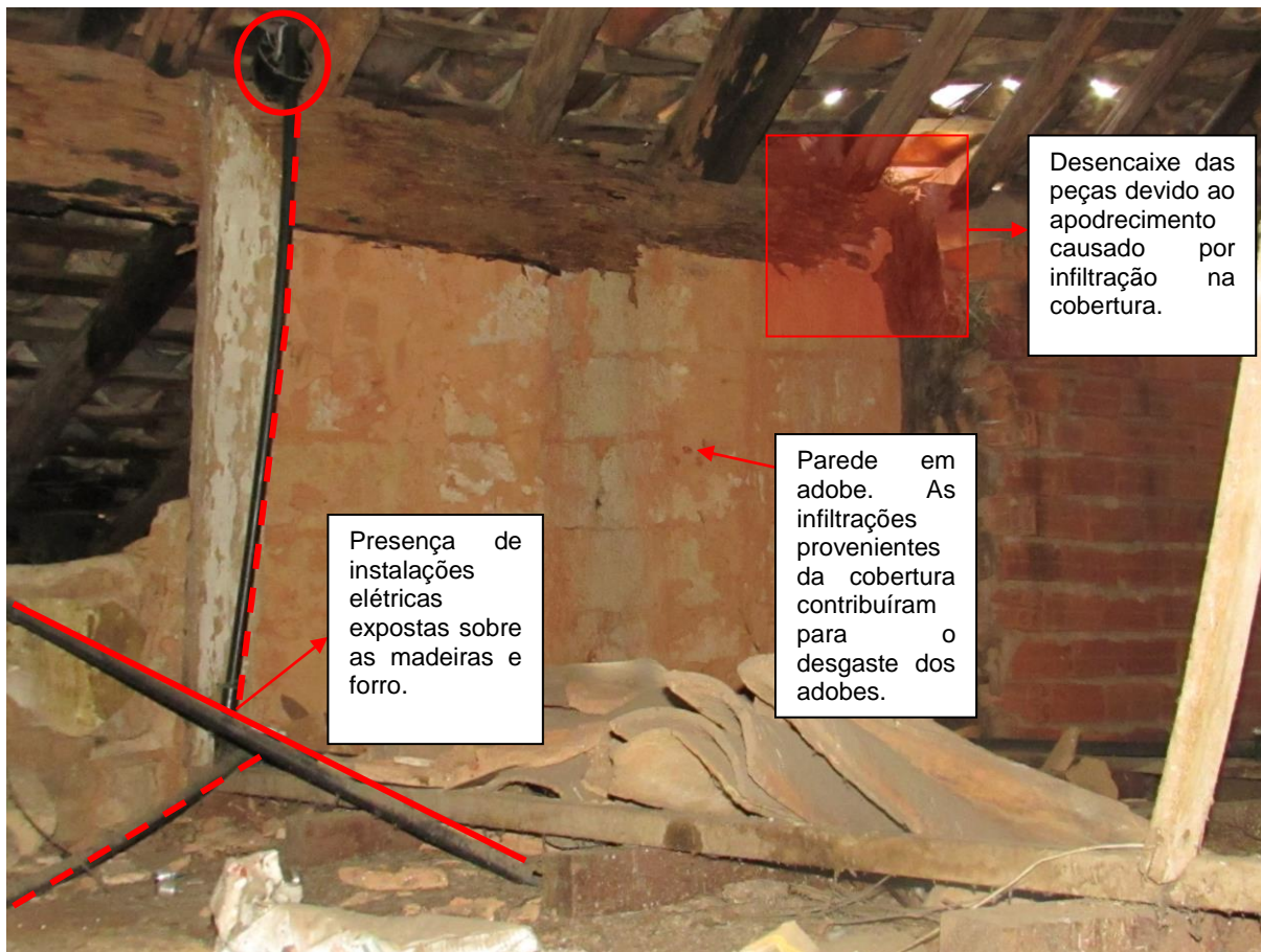
Figura 26 Vista interna da cobertura, com anomalias especificadas.
