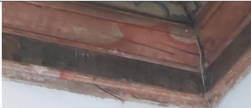
Detalhe do forro de gamela da Sala 1 observando o escurecimento da pintura do arremate inferior e rachaduras no suporte.
