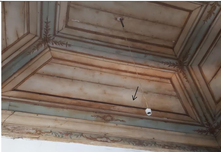
Detalhes do forro de gamela da Sala 19 onde se observa a perda de friso na face norte.
