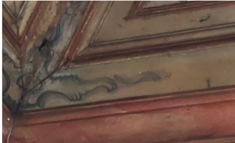
Detalhe do forro de gamela da Sala 1 apresentando área de podridão e perda no suporte.
