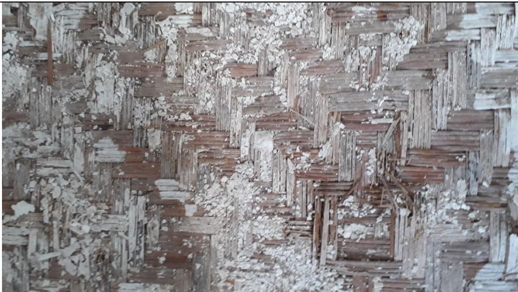
Detalhe da esteira que se encontrava fixada nos caibros e que foi removida na atual intervenção pelo precário estado de conservação. Todas as esteiras eram similar a esta.
