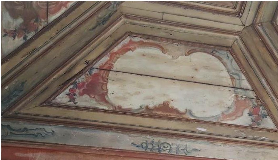
Detalhe do forro de gamela da Sala 01 notando-se orifícios e perdas de suporte em friso devido ao ataque de insetos xilófagos (cupins). Observam-se rachaduras e muitos cravos e pregos oxidados.
