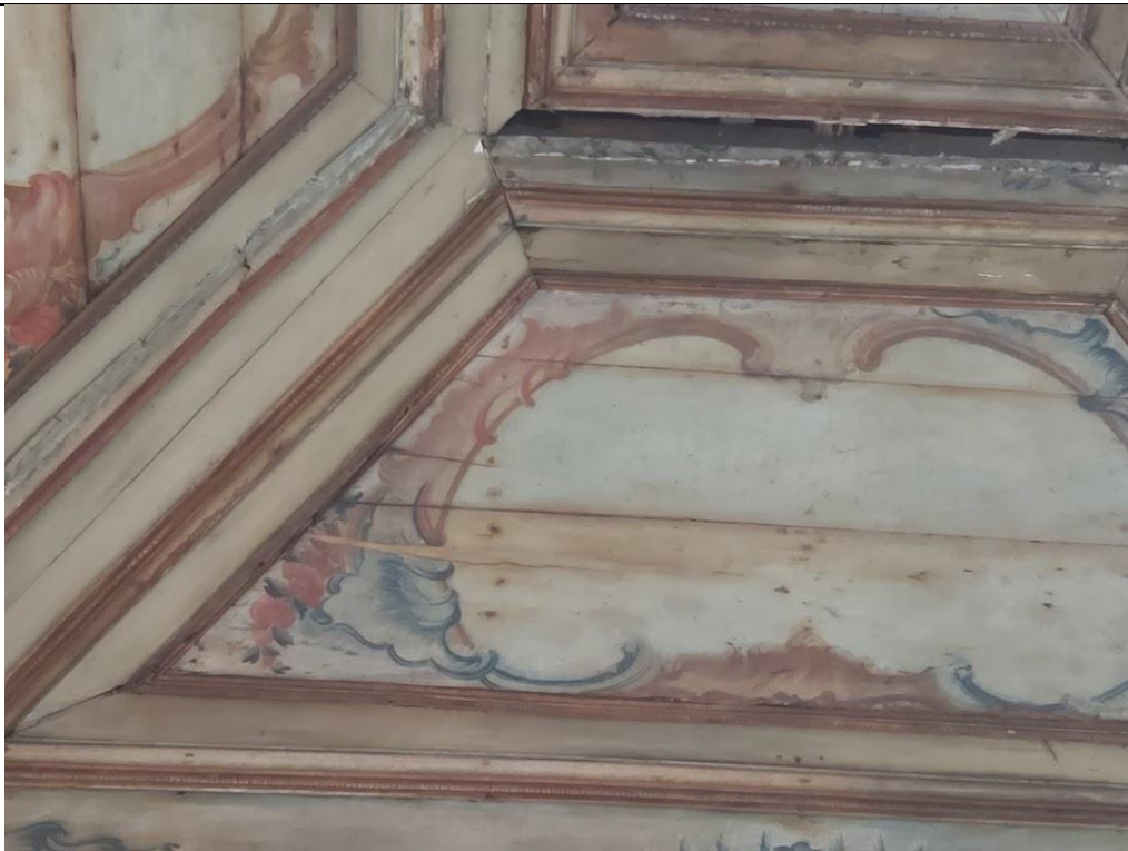
Detalhe do forro de gamela da Sala 01 observando as perdas de frisos nas faces do lado oeste e central.
