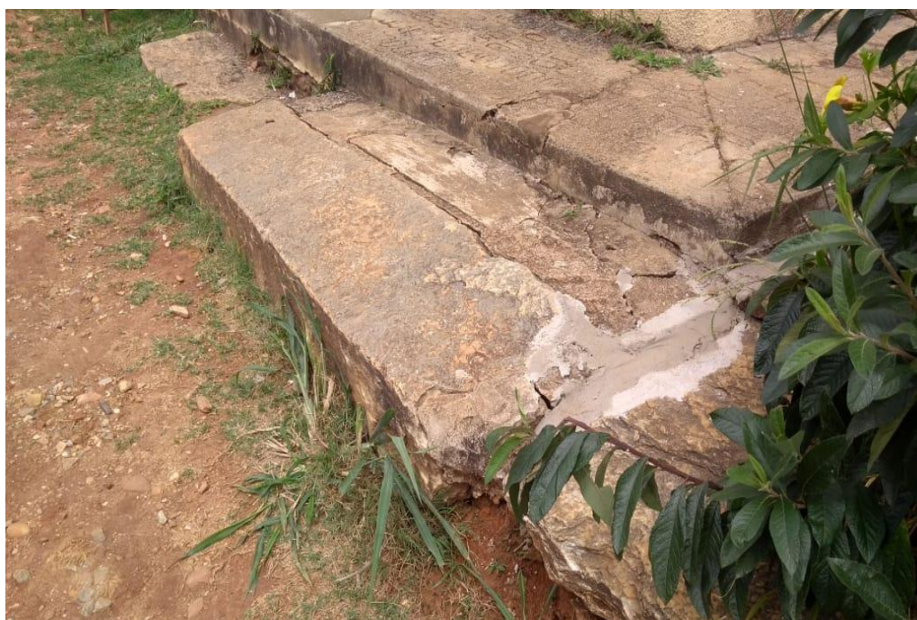
Imagem 14: Escada de acesso à lateral direita da Capela Santo Antônio-Ribeirão da Mata Fonte: Secretaria Municipal de Cultura e Turismo – Santa Luzia/MG. Data: 22/10/2020
