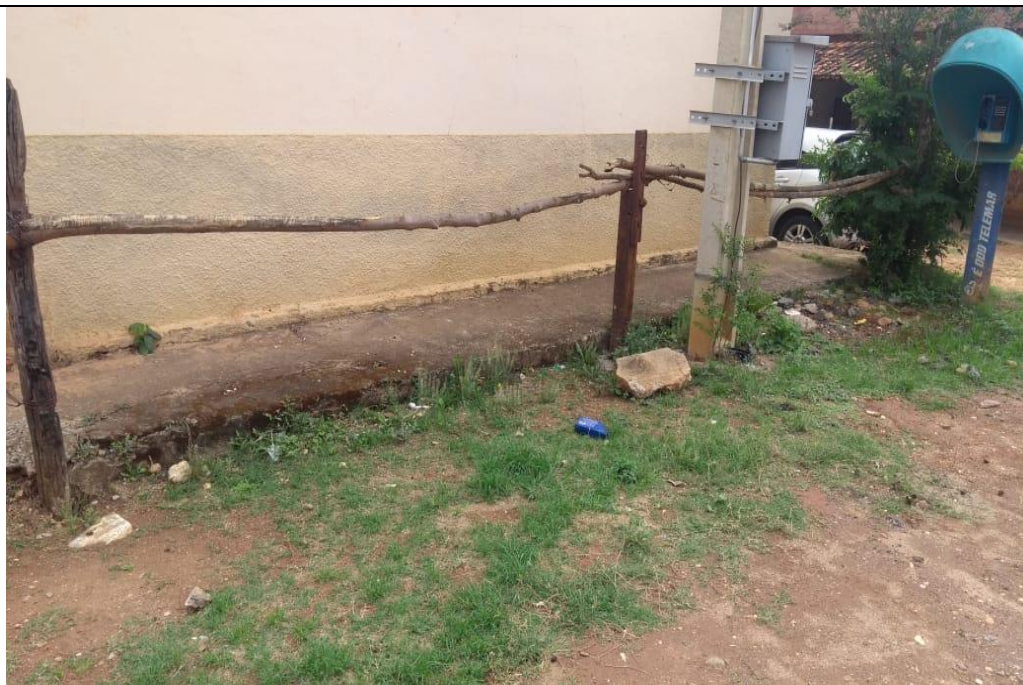
Imagem 17: Passeio fachada posterior da Capela Santo Antônio-Ribeirão da Mata Fonte: Secretaria Municipal de Cultura e Turismo – Santa Luzia/MG. Data: 22/10/2020
