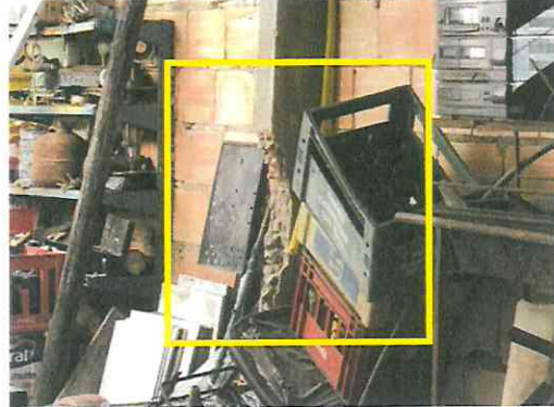
Figura 6. Patologia existente que ocasiona RISCO IMINENTE no local (sugere-se a visita da defesa civil no local para interdição, caso necessário)
