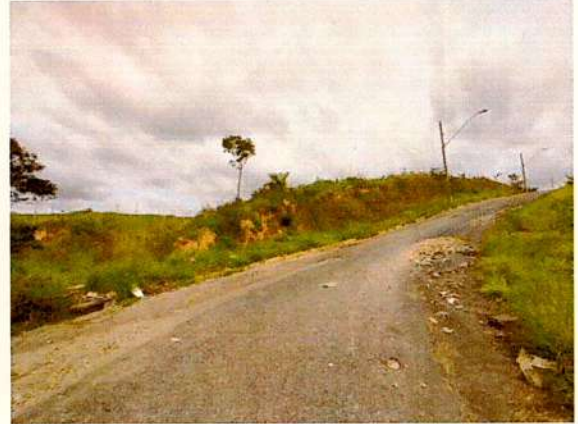
Foto 2. Visada da quadra 25 na altura do lote 22 da Rua Moacir Mundim e passagem de pedestres não implantada. Aclive notado e cabos de energia entre os postes cortados.
