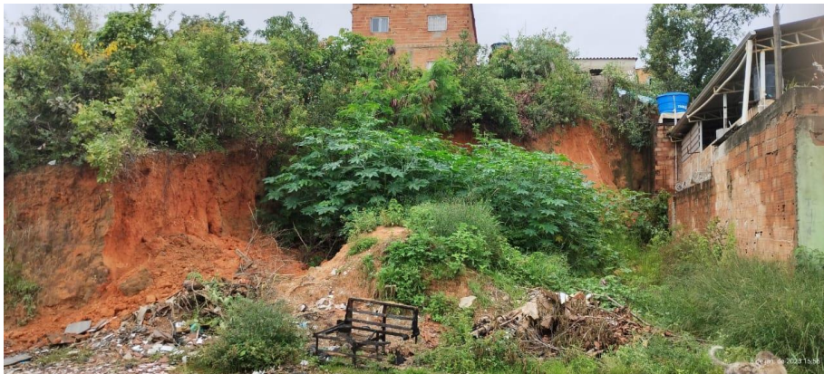
05- Deslizamento de talude na Rua Maracandi nº 20 Bairro Três Corações.
