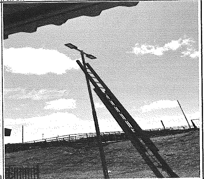
Foto 28: Luminaria do poste
